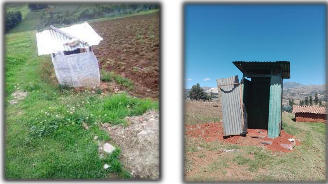
Figura 37: Letrinas en mal estado
