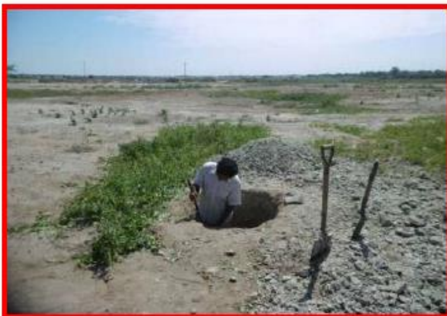
Foto 3. Ubicación de Calicata C-2.
