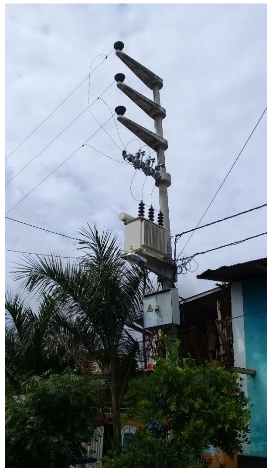
Estructura de SED 66
