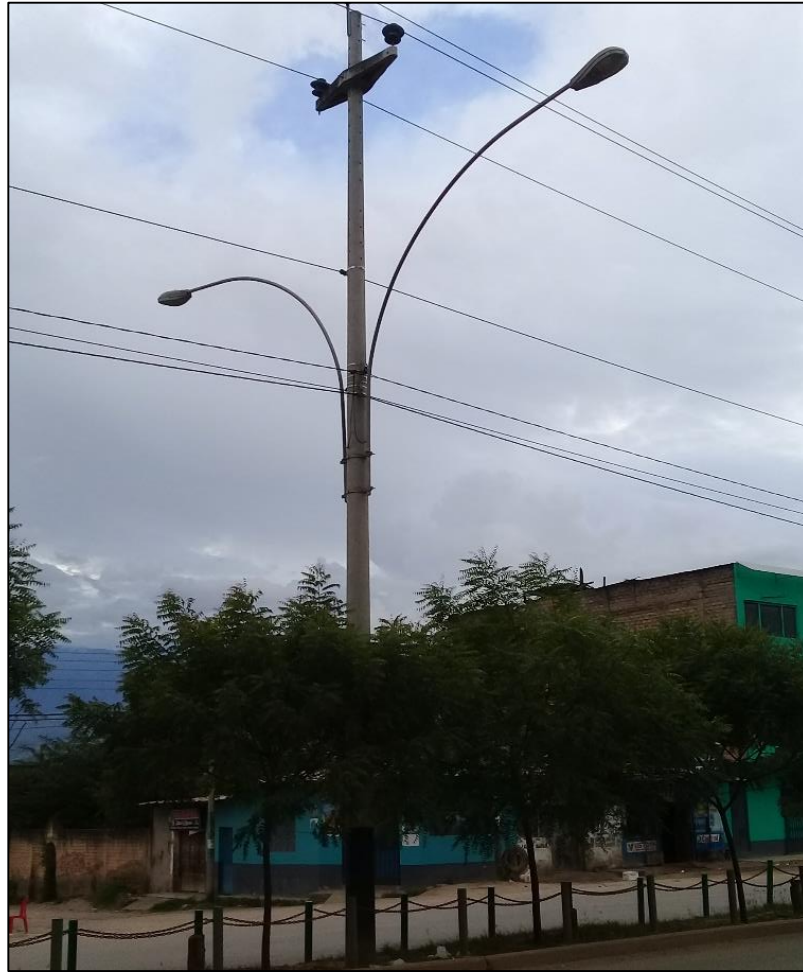
Figura 12: Luminaria de alumbrado público.
