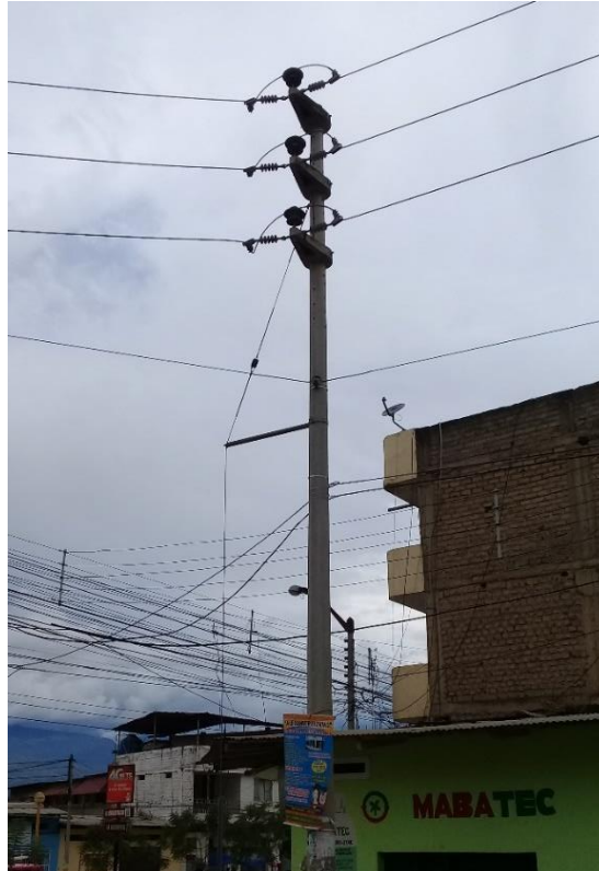
Figura 6. Conductor eléctrico instalado en estructura de concreto.
