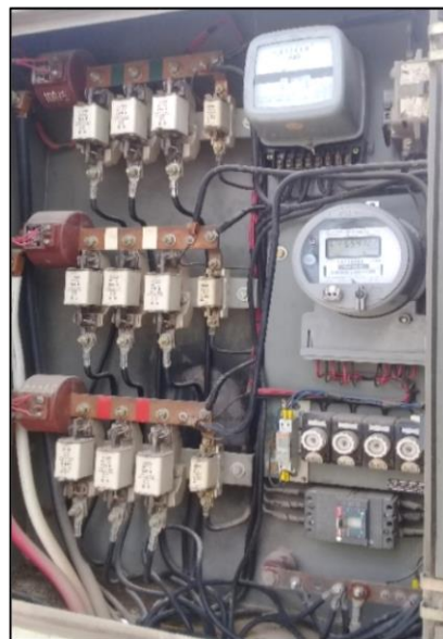
Figura 10: Tablero de distribución.
