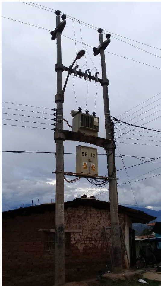
Estructura de SED 12
