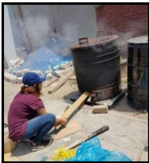
Figura 3.23 Colocación del combustible
