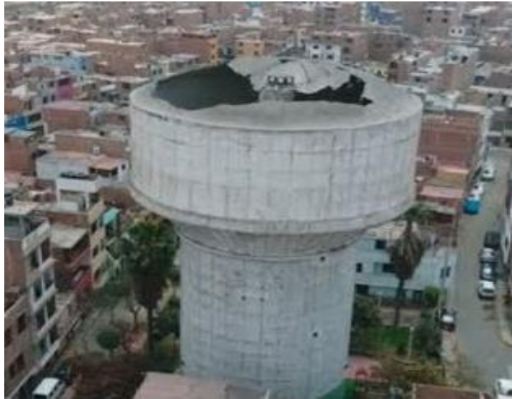
Figura I-2: Cúpula de Tanque de agua colapsada
