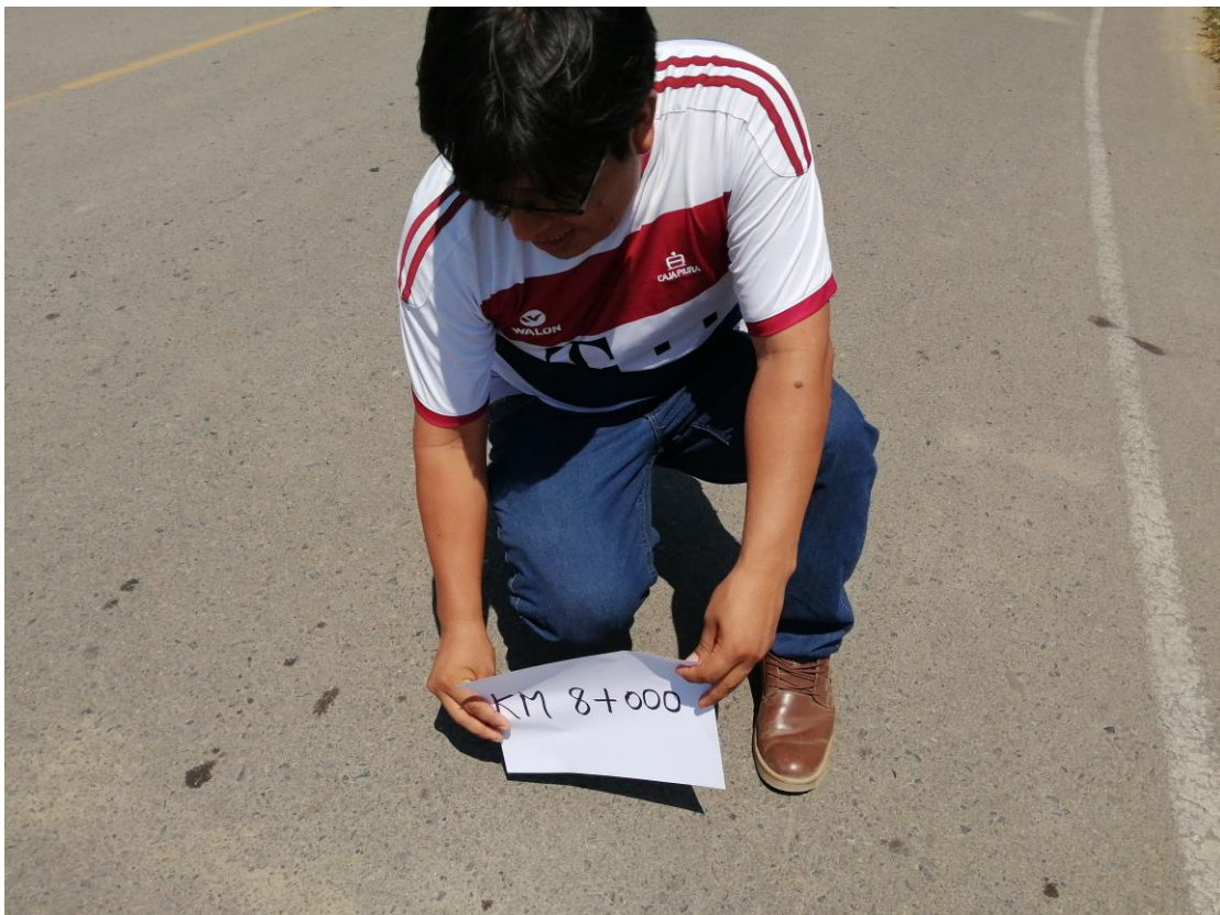
Figura N° 10: Fallas en el pavimento progresiva km 8 + 000
