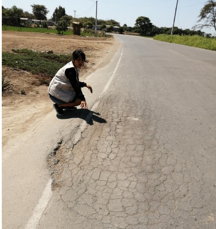
Figura N° 03: Falla piel de cocodrilo
