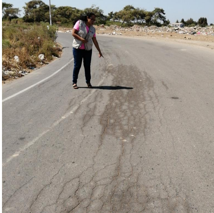
Figura N° 05: Falla piel de cocodrilo
