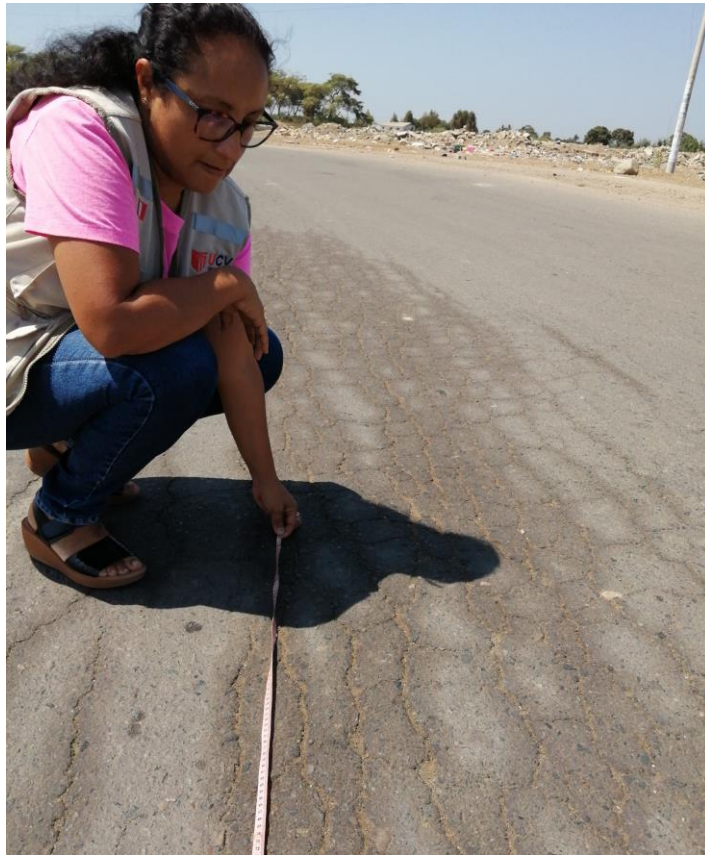
Figura N° 07: Medición de la Falla piel de cocodrilo
