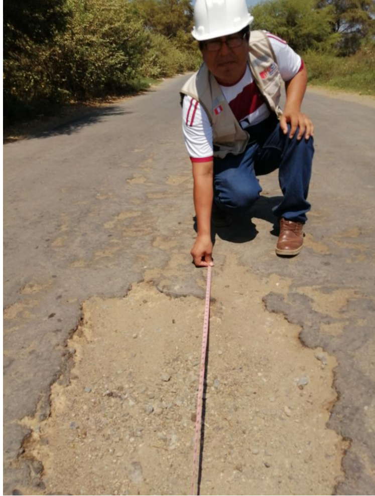
Figura N° 11: Medición de falla hueco.
