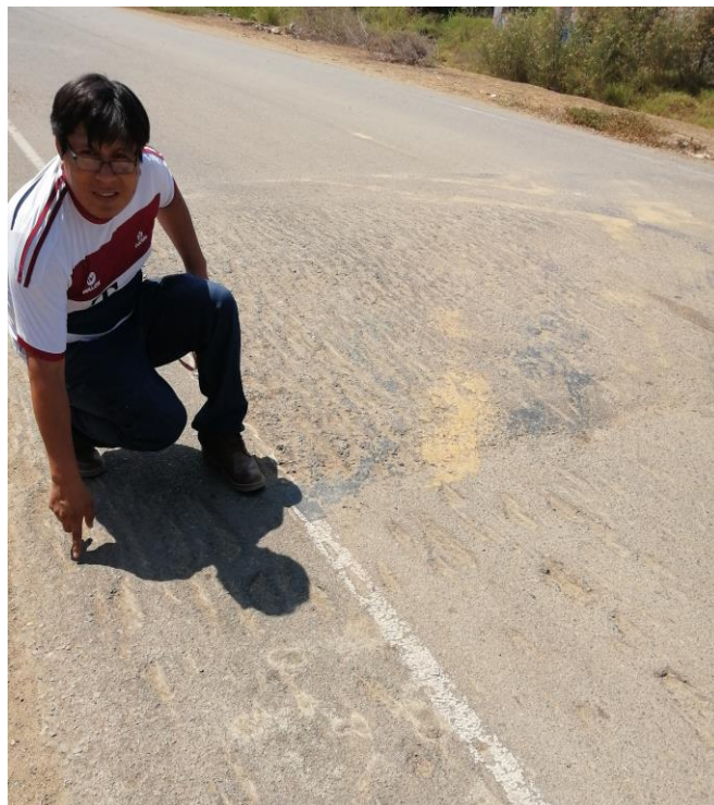
Figura N° 02: Falla pulimiento de agregados.
