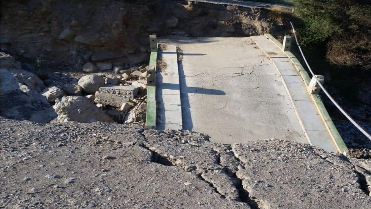
Fotografía 3: Se puede observar el puente Collambay caído por la inundación que se dio en el año 2017. Fuente: Elaboración propia.
