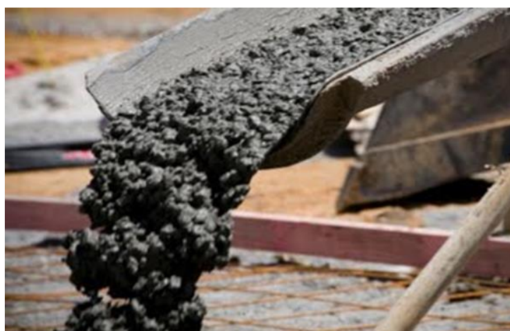
Figura 5. El estado del concreto al momento de combinar elementos
