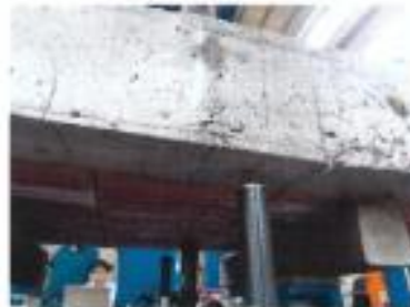
Figura 19. Vista de la flecha producida por la carga (P-02)
