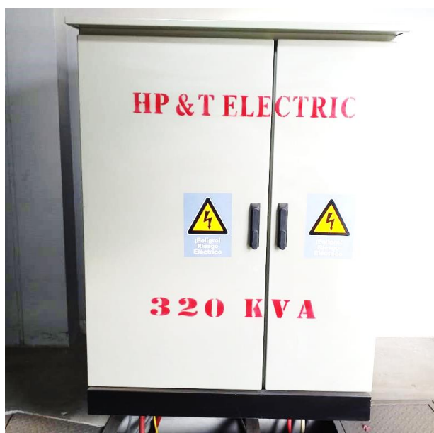
Fig. 3.13 Transformador del CIT
