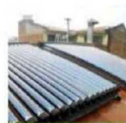
CAPTACION DE RADIACION Y AGUAS PLUVIALES
