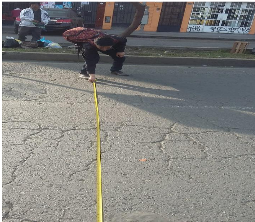
Foto N° 02: Medición de las fallas del pavimento
