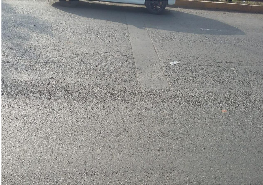
Foto N° 03: Tipo de falla parches en la Av. Metropolitana.
