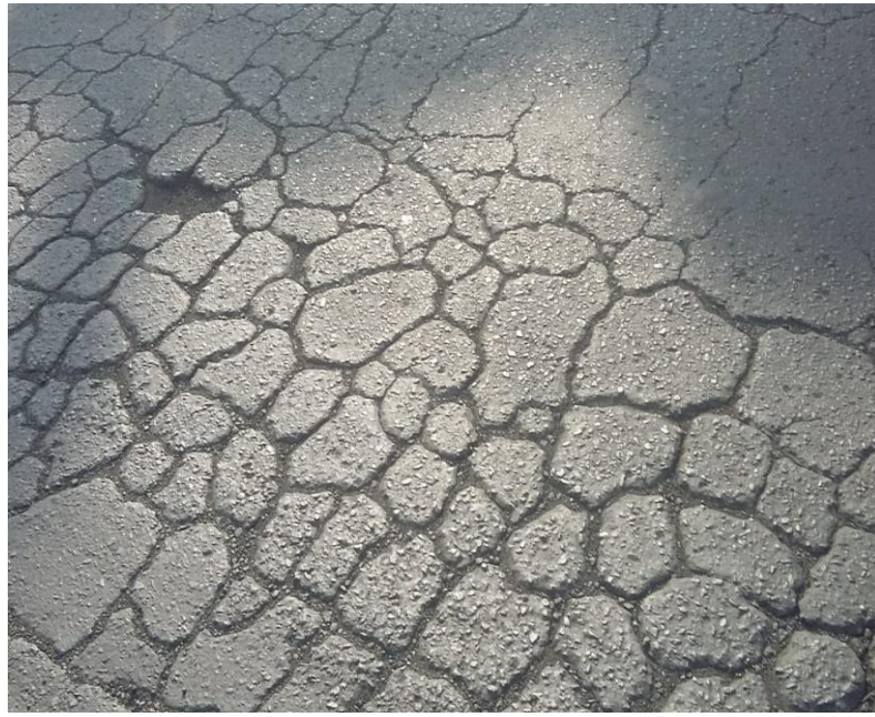
Foto N° 01: Tipo de falla Piel de Cocodrilo en la Av. Metropolitana.
