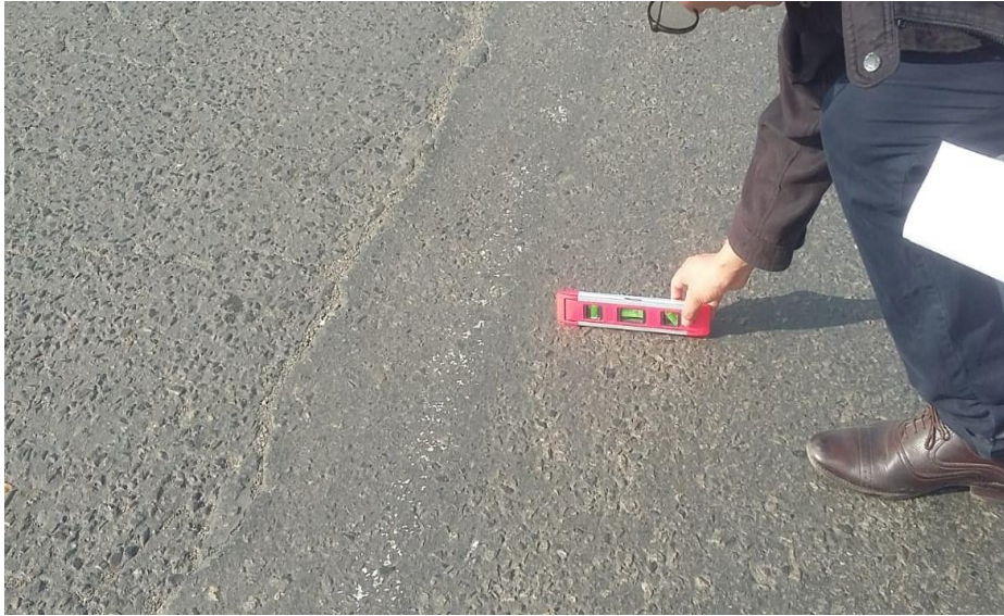
Foto N° 05: Tipo de falla Ahuellamiento en la Av. Metropolitana.
