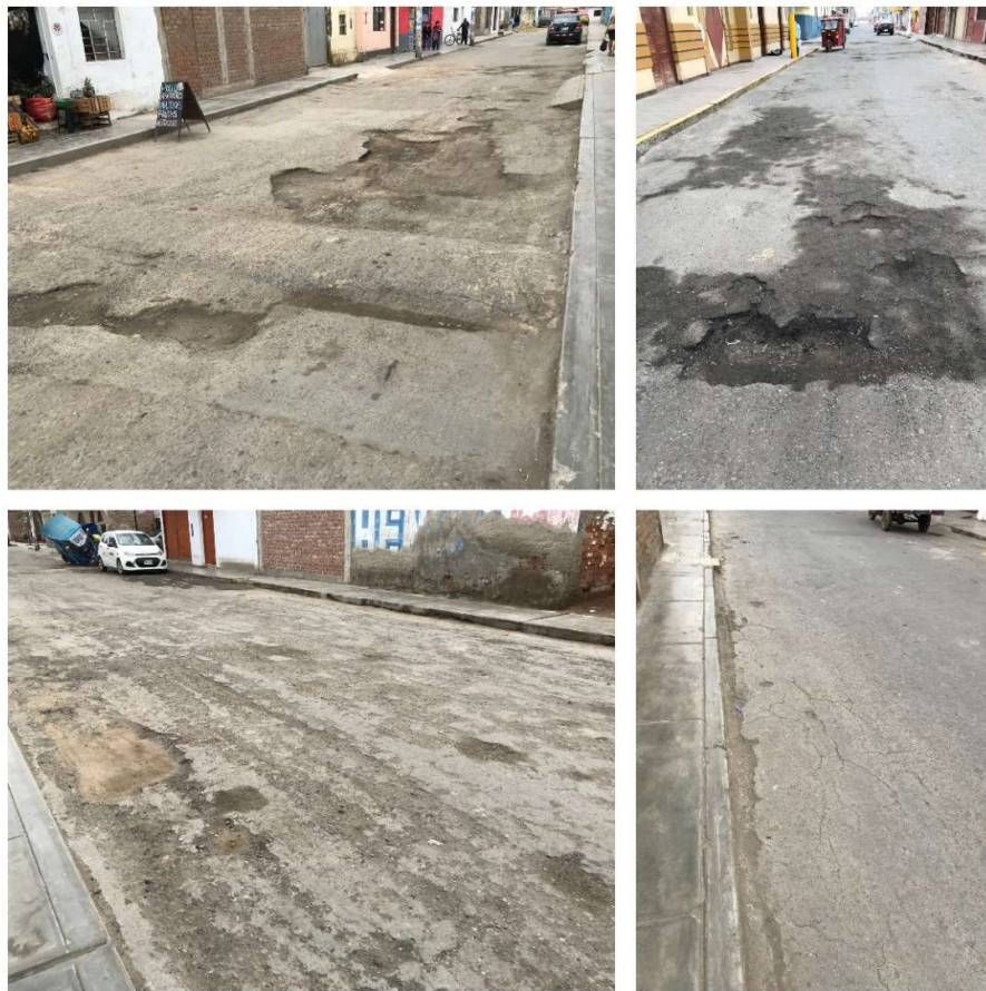
Fig. 06 – Condición actual del pavimento
