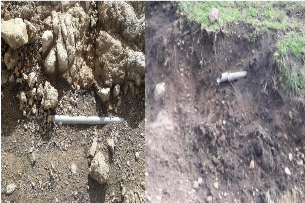
FOTOGRAFÍA 5. SE OBSERBA TUBERÍAS DE REDES DE DISTRIBUCIÓN EXPUESTAS A LA INTERPERIE
