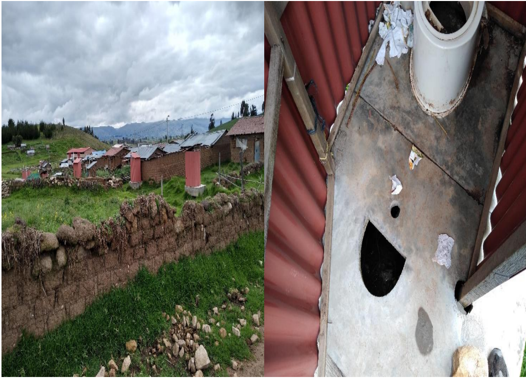
FOTOGRAFÍA 7. SITUACIÓN ACTUAL DE LAS LETRINAS EN MAL ESTADO
