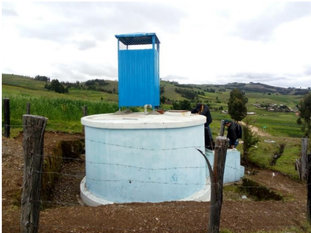
FOTOGRAFÍA 4. SE OBSERVA EL RESERVORIO ANTERIOR EN MAL ESTADO
