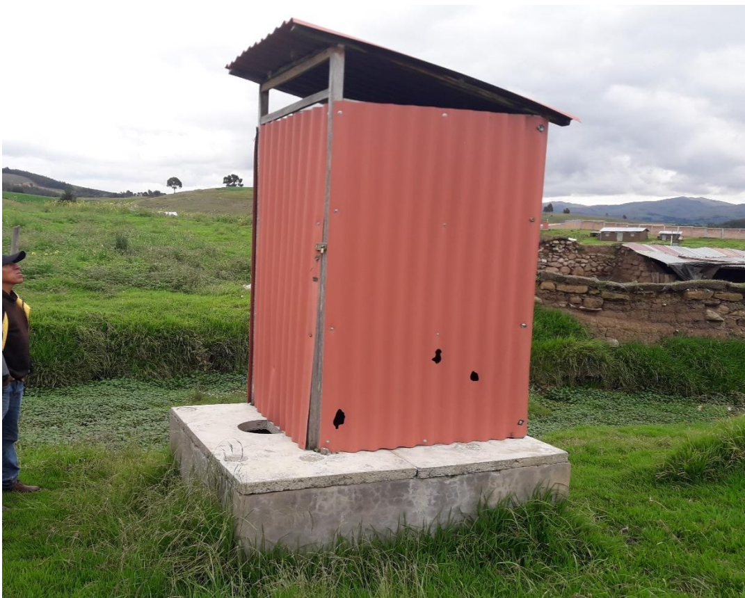
FOTOGRAFÍA 8. SE OBSERABA UNA UBS TIPO COMPOSTERA COLAPSADO
