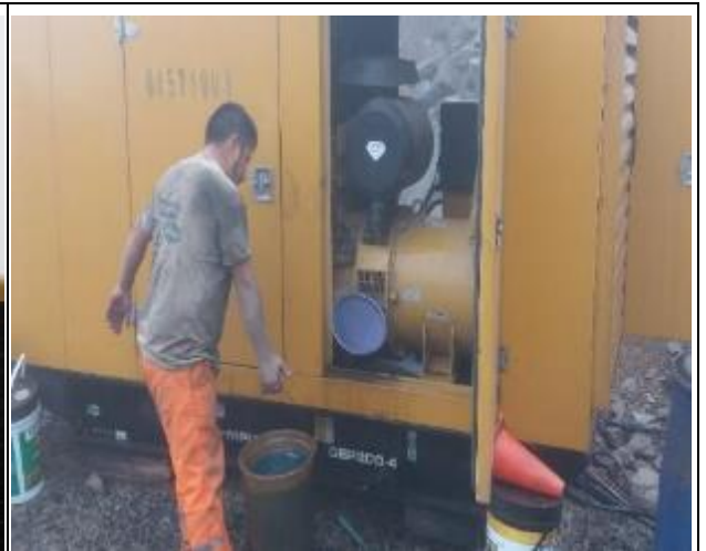
Grupo electrógeno abastecido de combustible por baldes.
