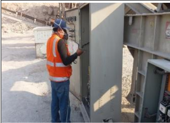
Check list de la parte eléctrica y mecánica antes del inicio de la jornada.
