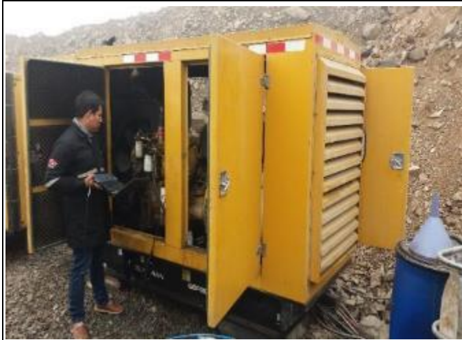
Inspección y mantenimiento preventivo del grupo electrógeno por parte de especialistas.
