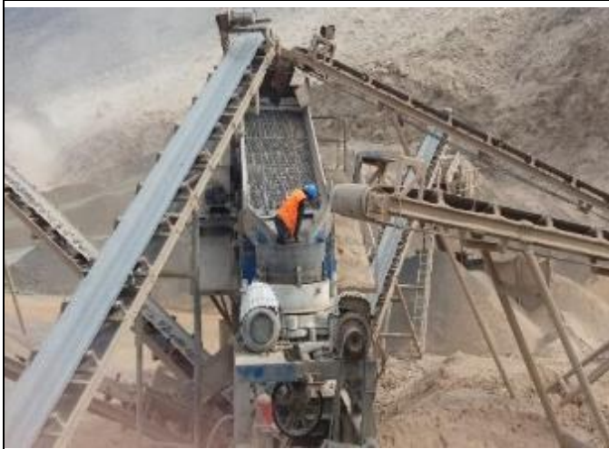
Paralización de la planta chancadora por atormamiento en la trituradora secundaria. Falla del sistema eléctrico.
