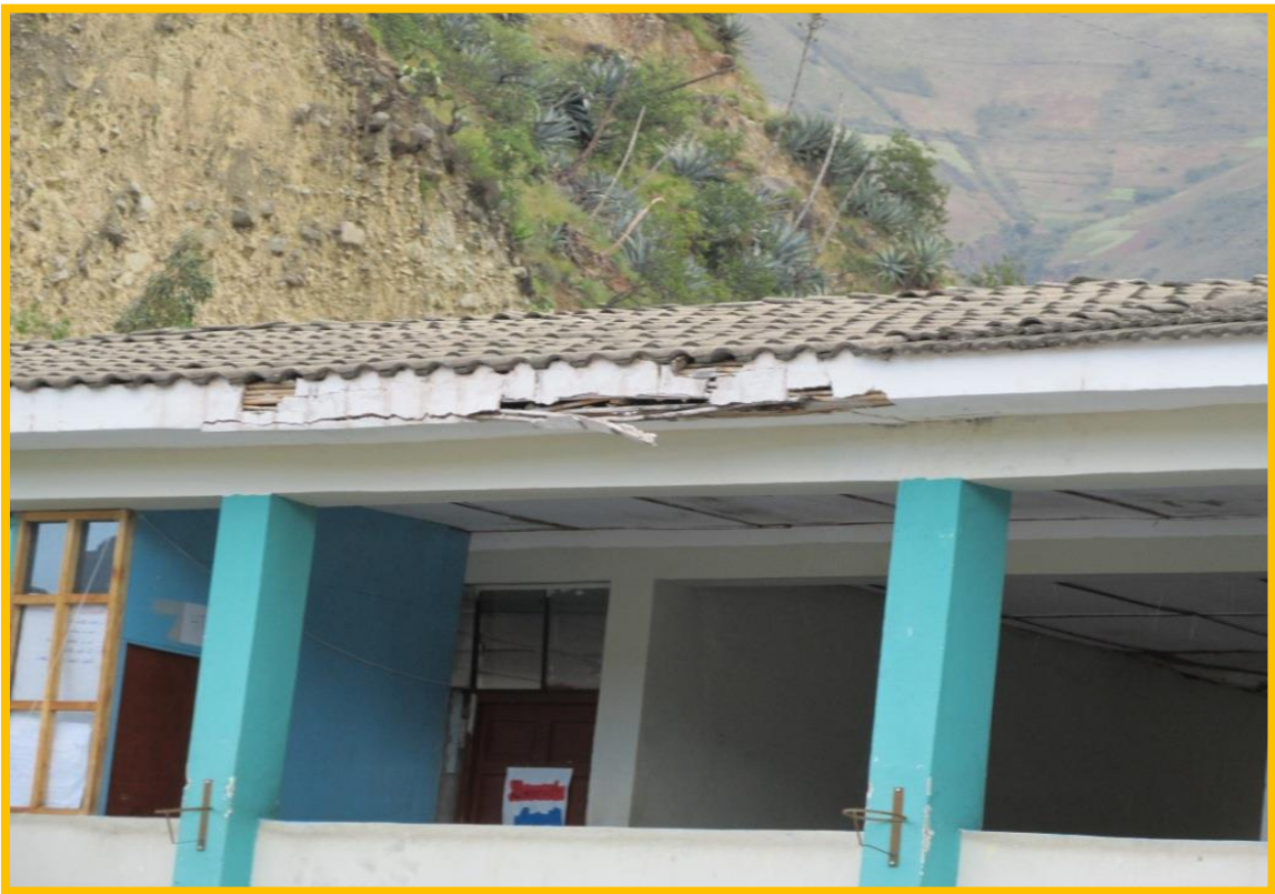
Fotografía 10. Vista actual de las condiciones estructurales de la institución educativa 9 de diciembre.
