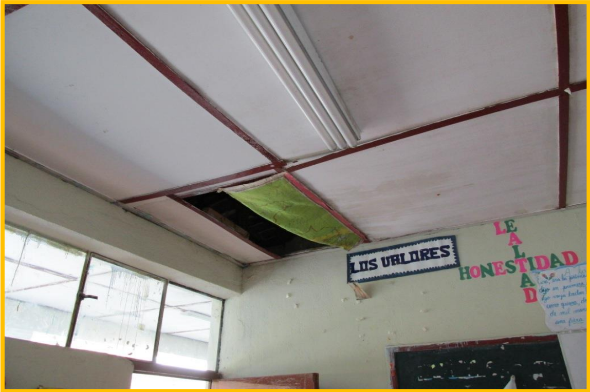
Fotografía 9. Vista de la condición de las aulas de la institución educativa 9 de diciembre.
