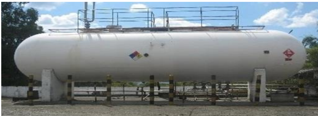
Figura 2 Tanque cilíndrico horizontal
