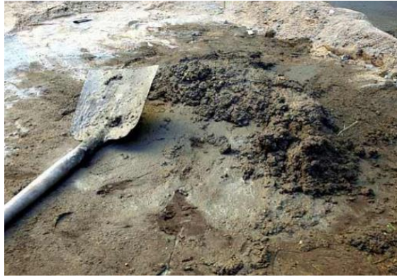
Figura 2. El mortero para asentado de ladrillo no es de la calidad requerida según su uso.
