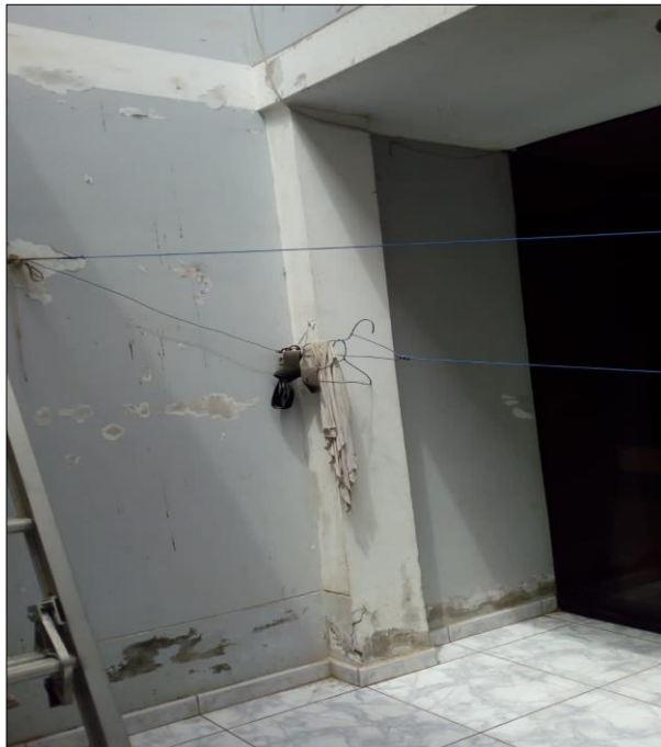
Figura 2 Eflorescencia en la columna por la filtración de agua Fuente: Elaboración personal
