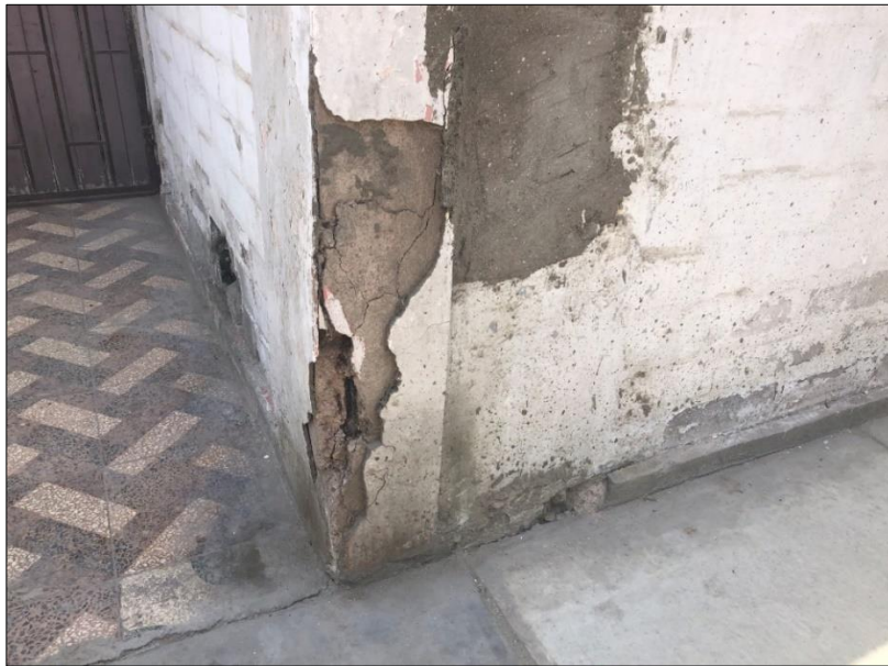
Figura 3 Descascaramiento de la Columna por la filtración de agua Fuente: Elaboración personal
