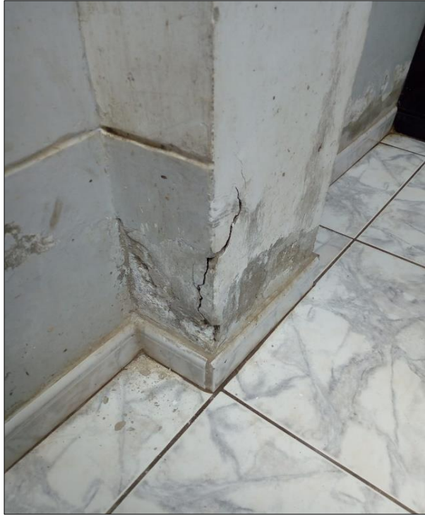
Figura 1 Grieta en la de Columna por la filtración de agua Fuente: Elaboración personal
