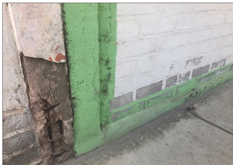
Figura 4 Acero de refuerzo corroído por la humedad Fuente: Elaboración personal
