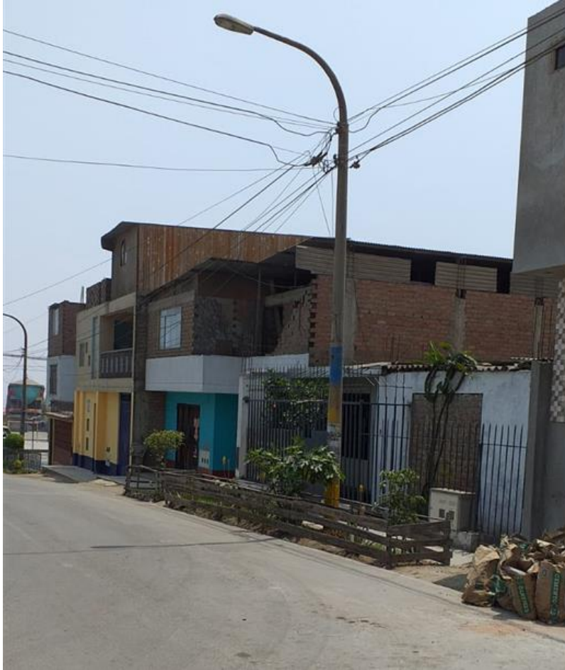
Viviendas autoconstruidas, muros inestables y techos con cobertura ligera en malas condiciones
