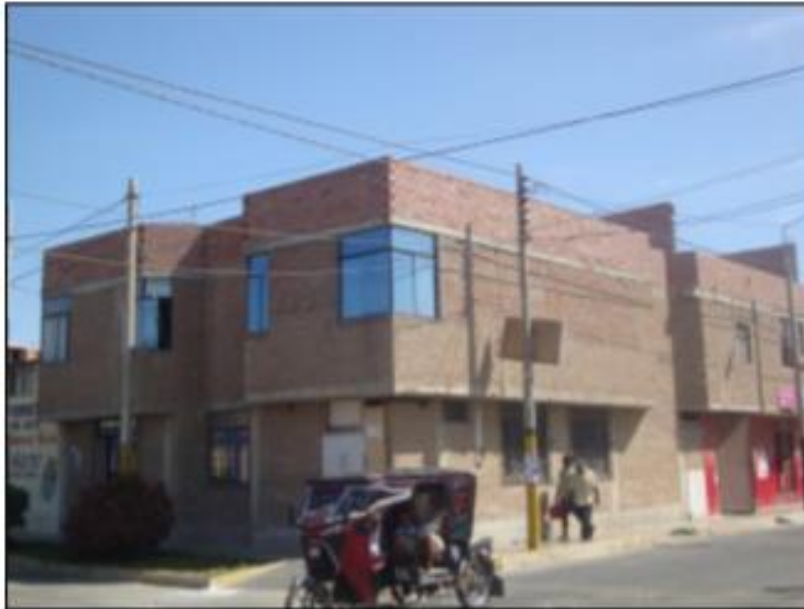
Figura 14. Edificaciones con tabiquerías y parapeto no arriostrados. Fuente: Elaboración propia
