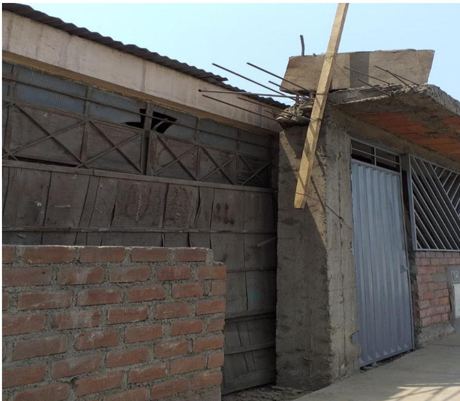
Anclajes inadecuados en viga y columna
