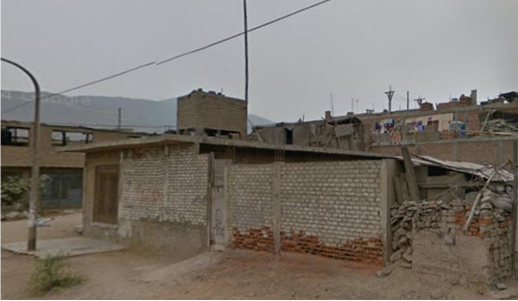
Edificación con deficiencias por presencia de humedad en el primer nivel.
