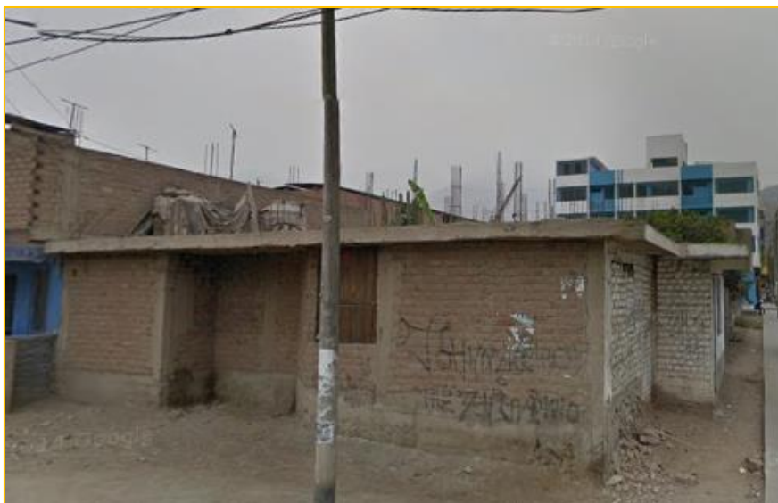
Figura 8. Edificación de albañilería, sin elementos de arrioste en sus cuatro lados, sin adecuada distribución de muros y regularidad. Fuente: Elaboración propia
