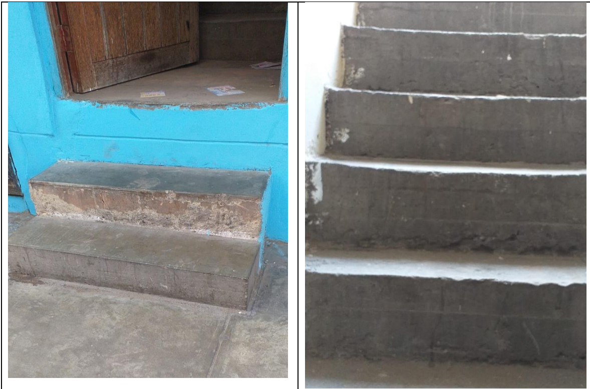
Escalera principal, gradas de inicio en vereda y con el contrapaso de 0.20cm, incumple la Norma.
