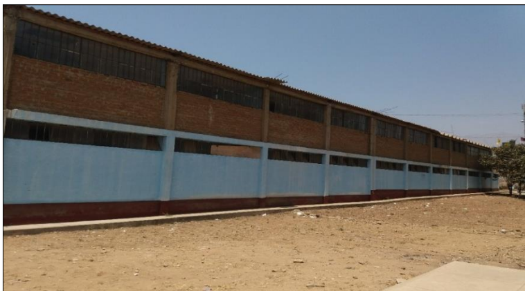
Figura 1. I.E Antenor Orrego, fachadas en mal estado
