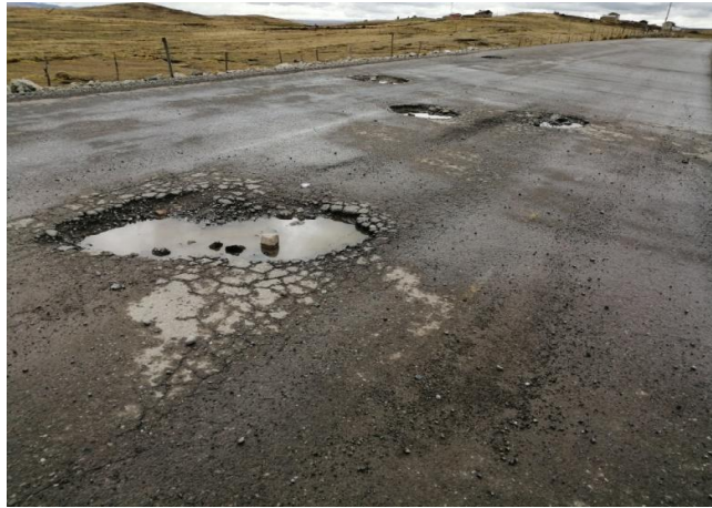
Figura 1. Baches en la carretera Cerro de Pasco – Yanahuanca
