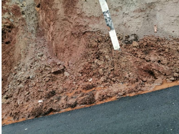
Figura 4. Deslizamiento de suelos en la carretera Cerro de Pasco – Yanahuanca
