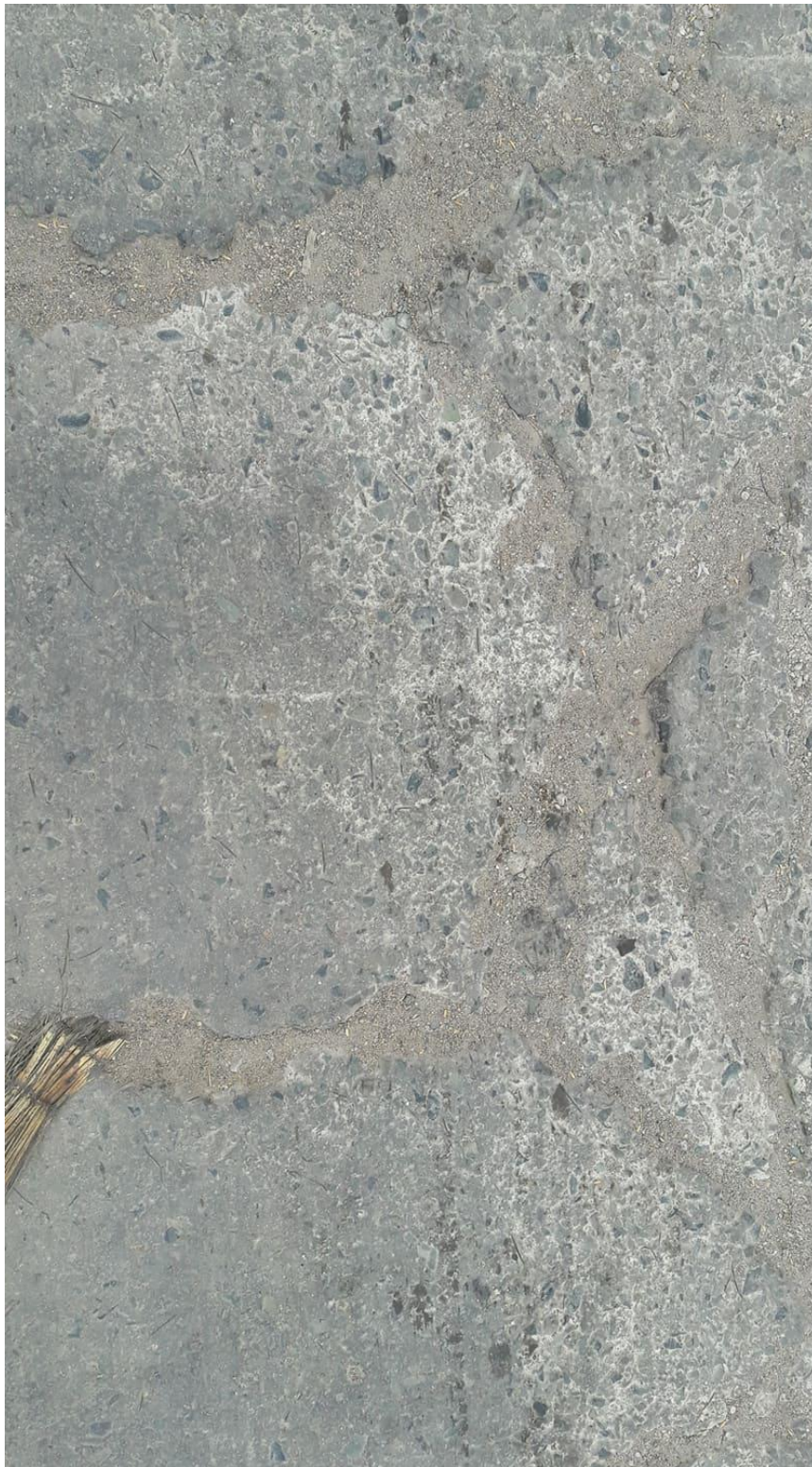
Figura N° 8: Grietas en bloque
