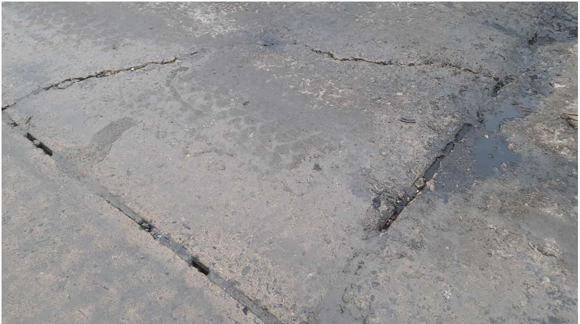
Figura N° 6: Grieta de esquina
