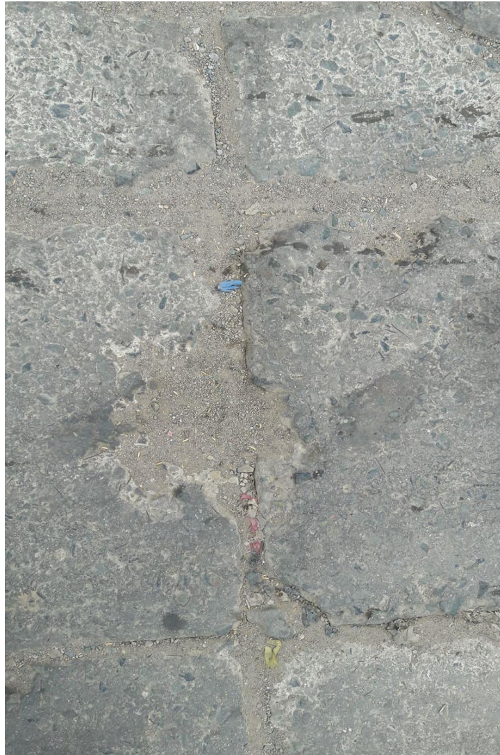
Figura N° 7: Descascaramiento de juntas
