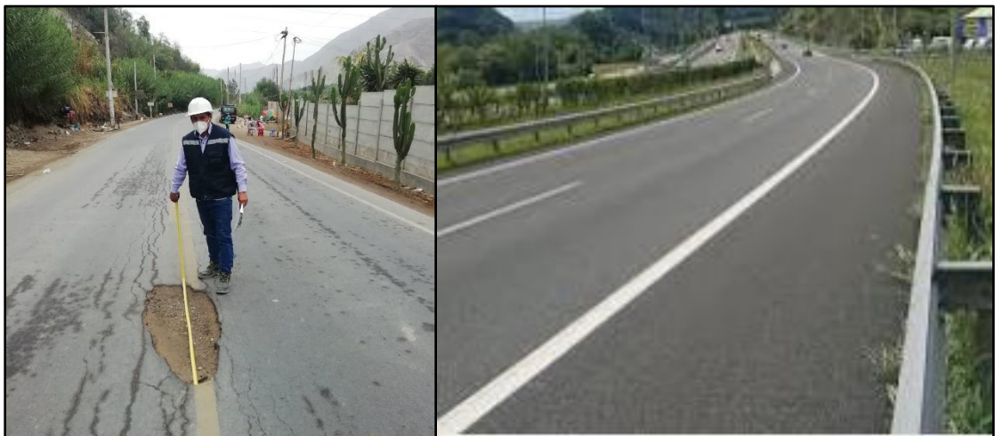
Figura 44. Estado real de la carretera a Lunahuana e ideal propuesto Fuente: Propia
