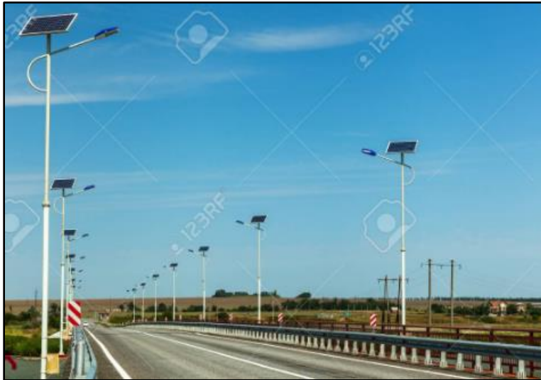
Figura 56. Energía alternativa en carreteras Fuente: 123RF (2021)
