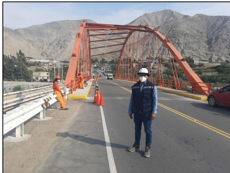
Figura 25. Estructuras viales con algunas deficiencias ambientales Fuente: Propia
