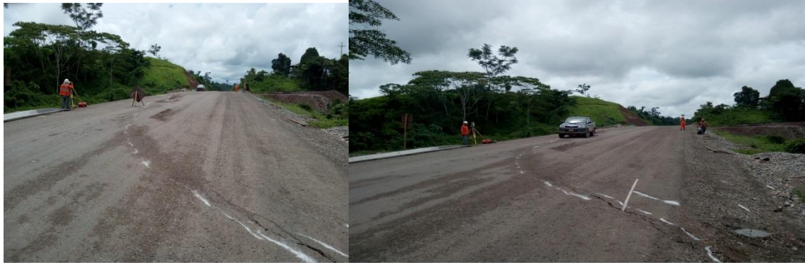
Foto N° 05: Levantamiento de grietas a consecuencia de desplazamiento rotacional km:38+360 al 38+450
