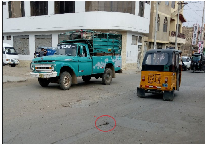
Figura 4: Agrietamiento leve y deterioro en la calzada
