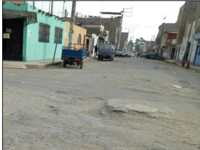
Figura 10: Problemas de nivel de buzón, por deterioro de calzada Fuente: Elaboración propia
