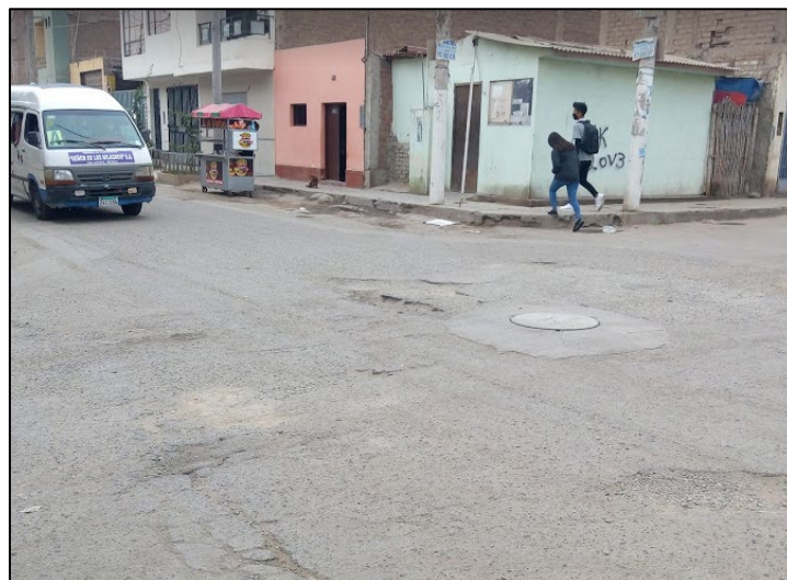
Figura 36: Avenida 28 de Julio - Baches y agrietamiento
