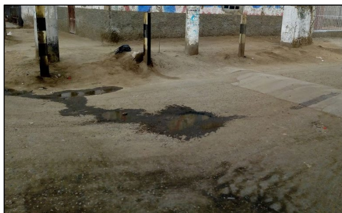
Figura 5: Baches cerca al Mercado Megacenter
