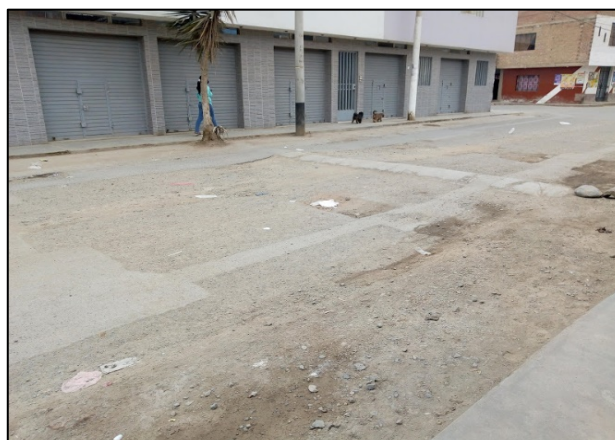
Figura 34: Avenida 28 de Julio – Problemas de calzada
