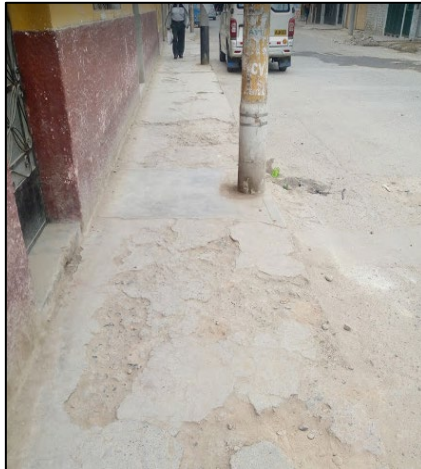
Figura 35: Avenida 28 de Julio - Desprendimiento de vereda
