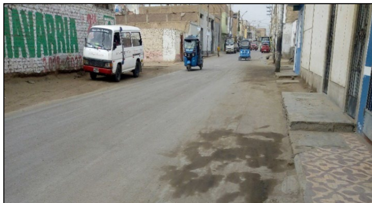
Figura 40: Jirón Augusto B. Leguía – Problemas en la vía
