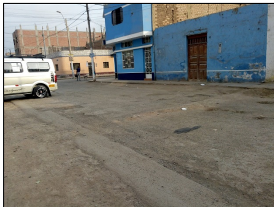
Figura 38: Avenida 2 de mayo - Desgaste en la vía
