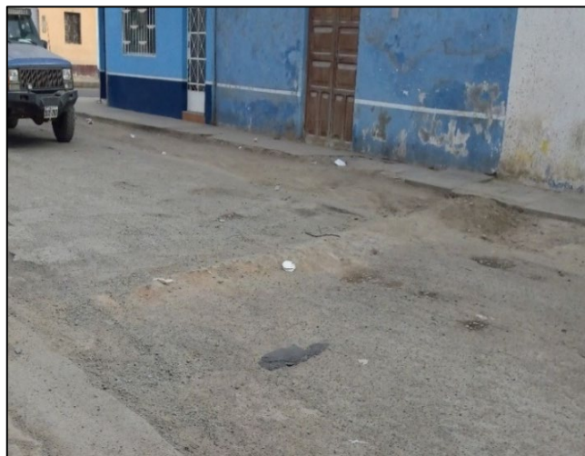
Figura 8: Desprendimiento e igualdad de nivel acera - calzada
