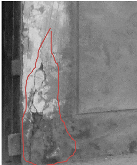
Figura37. Módulo 02 y 03 - Deterioro en la estructura vertical. Fuente: Archivos Fotográficos del Albergue para menores (2019)
