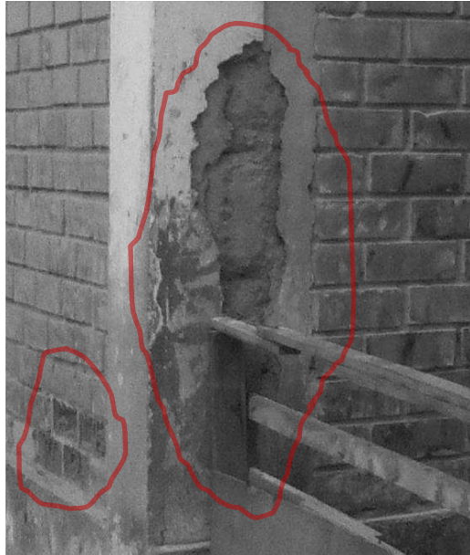
Figura36. Módulo 02 y 03 - Deterioro en la estructura vertical. Fuente: Archivos Fotográficos del Albergue para menores (2019)
