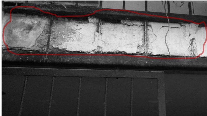
Figura38. Módulo 02 y 03 - Deterioro en la estructura horizontal. Fuente: Archivos Fotográficos del Albergue para menores (2019)
