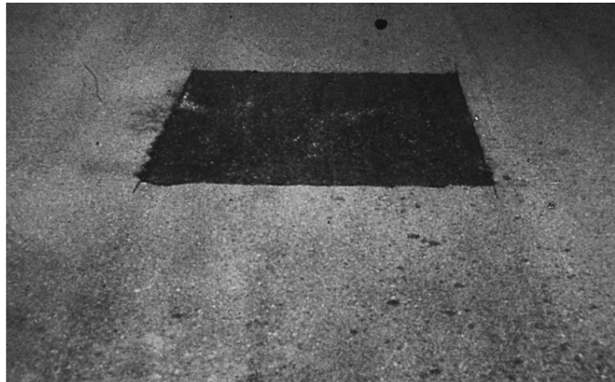
Figura 41 : Parqueo y acometidas de servicio públicos de baja severidad
