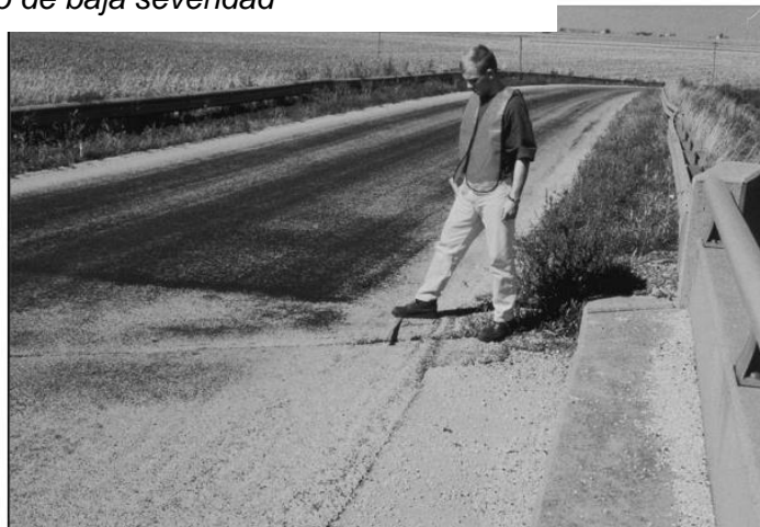
Figura 54 : Desplazamiento de baja severidad
