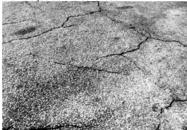
Figura 20 : Agrietamiento en bloque de alta severidad
