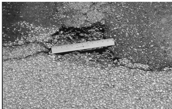
Figura 45 : Hueco de baja severidad
