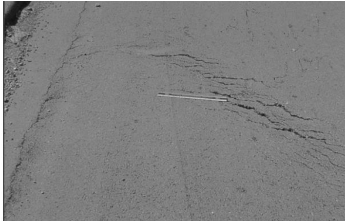
Figura 58 : Grietas parabólicas (slippage) de media severidad
