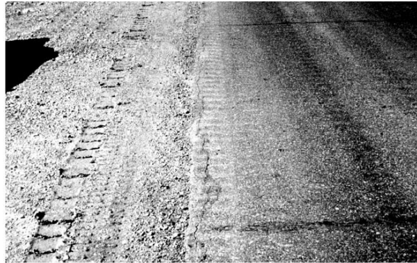
Figura 32 : Agrietamiento por reflexión de junta de baja severidad
