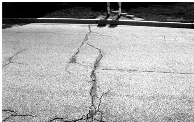
Figura 18 : Agrietamiento en bloque de media severidad
