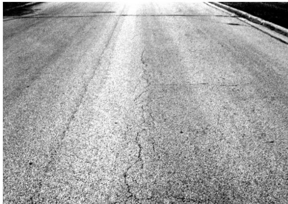
Figura 11 : Piel de cocodrilo de baja severidad
