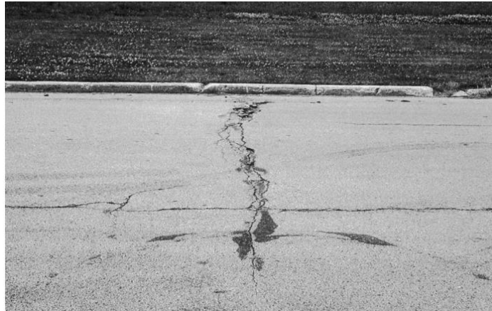
Figura 40 : Grietas longitudinales y transversales de alta severidad
