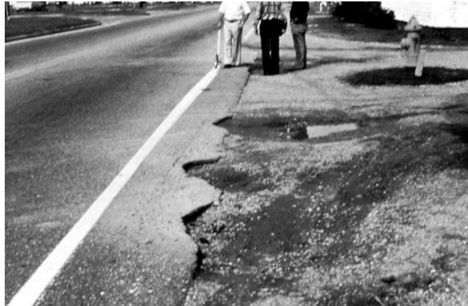
Figura 31 : Agrietamiento del borde de alta severidad
