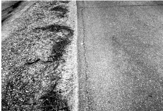
Figura 29 : Agrietamiento del borde de baja severidad
