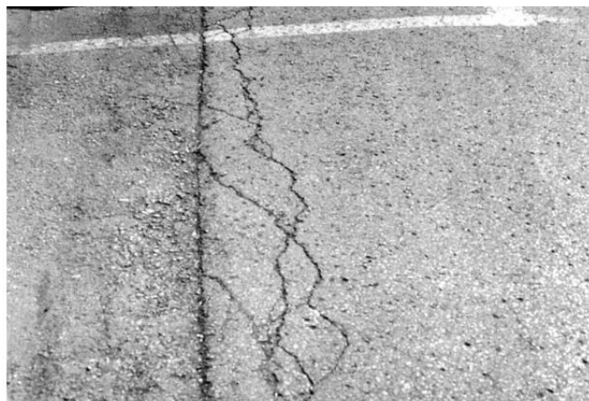
Figura 30 : Agrietamiento del borde de media severidad
