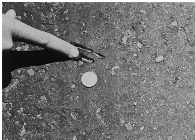
Figura 15: Exudación de media severidad
