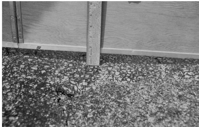
Figura 53 : Ahuellamiento de alta severidad
