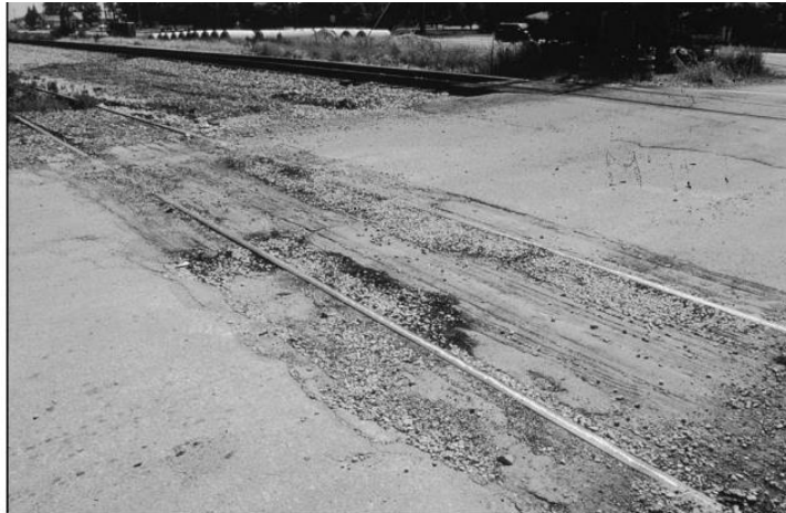
Figura 50 : Cruce de vía férrea de alta severidad
