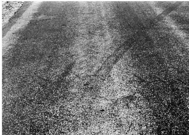
Figura 13 : Exudación de baja severidad
