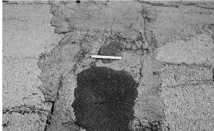
Figura 43 : Parqueo y acometidas de servicio públicos de alta severidad
