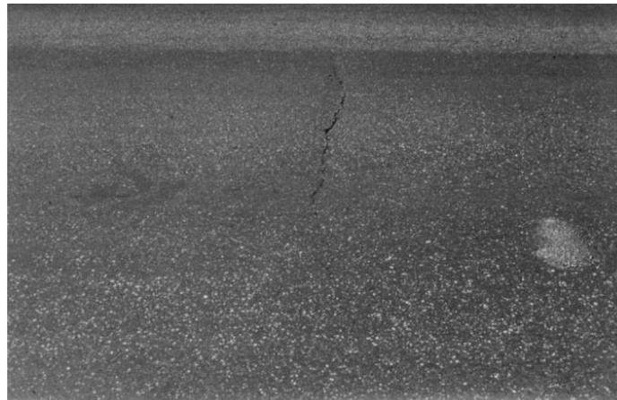
Figura 38 : Grietas longitudinales y transversales de baja severidad
