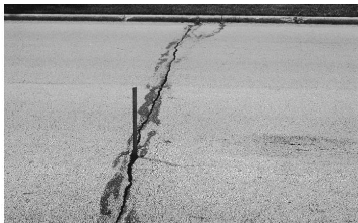
Figura 39 : Grietas longitudinales y transversales de media severidad
