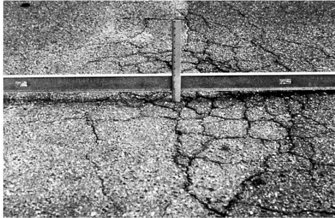
Figura 28 : Depresión de alta severidad
