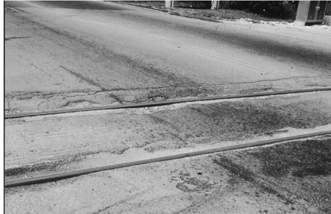
Figura 49 : Cruce de vía férrea de media severidad
