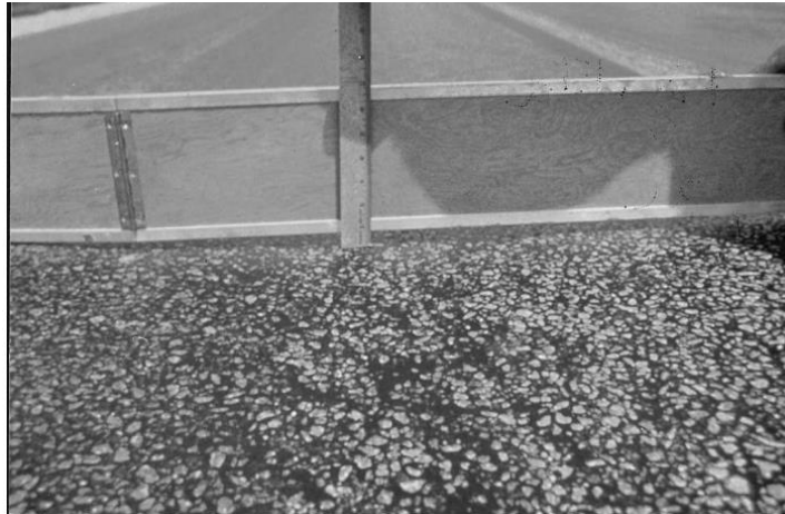
Figura 52 : Ahuellamiento de media severidad
