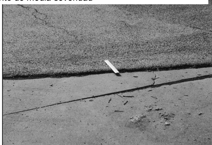
Figura 55 : Desplazamiento de media severidad
