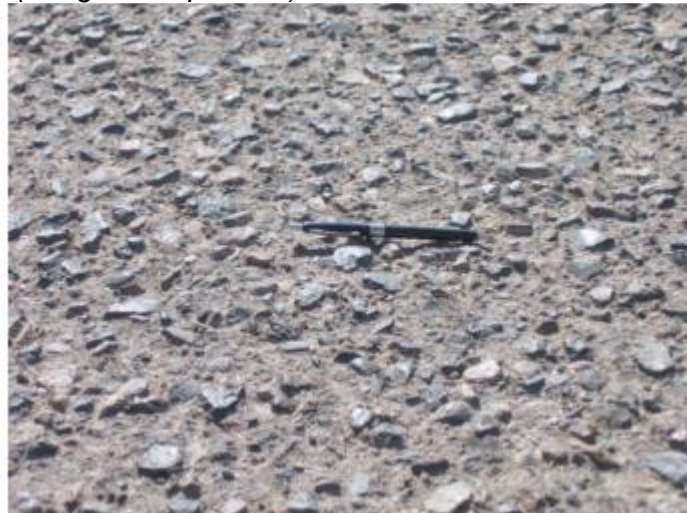
Figura 65 : Meteorización (Desgaste superficial) - Asfalto de mezcla denso de alta
