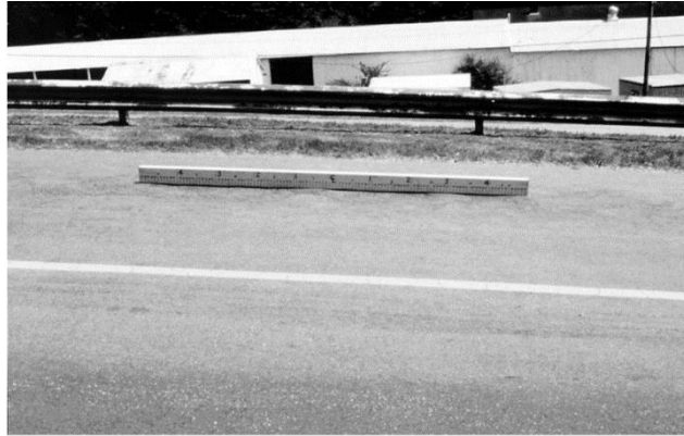
Figura 25 : corrugación de alta severidad.
