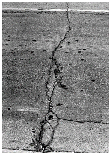
Figura 33 : Agrietamiento por reflexión de junta de media severidad
