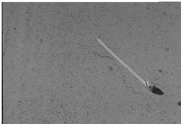
Figura 57 : Grietas parabólicas (slippage) de baja severidad
