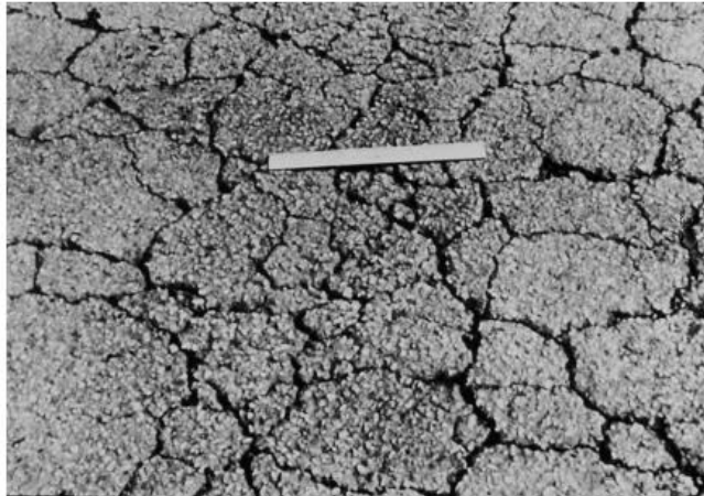
Figura 14 : Piel de cocodrilo de alta severidad
