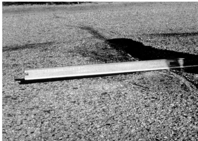
Figura 19 : Abultamientos (Bumps) Y Hundimientos (Sags) de baja severidad
