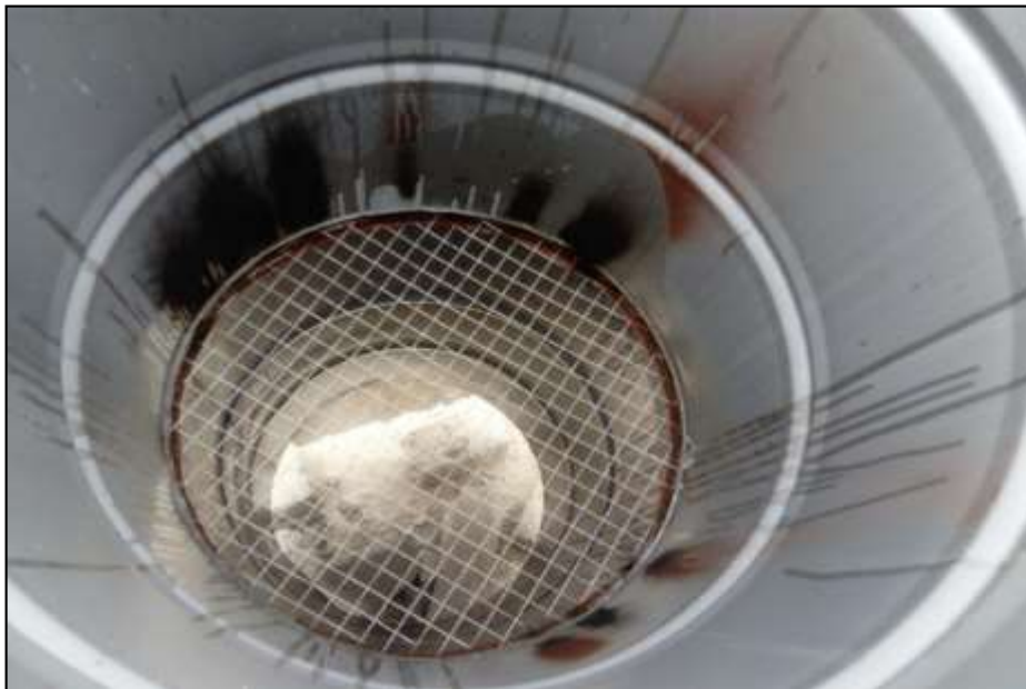
Figura 2. Interior del filtro biológico
