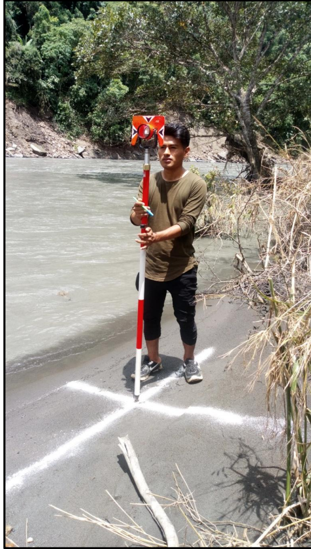
Fotografía 04. Se observa el uso de los prismas para la lectura de las coordenadas del levantamiento topográfico.
