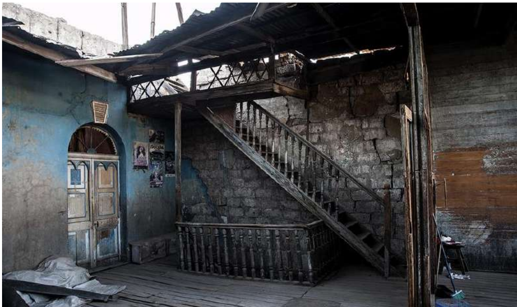
Foto N° 2. Degradación del Tambo Ruelas. Tomado del Diario El Búho.
