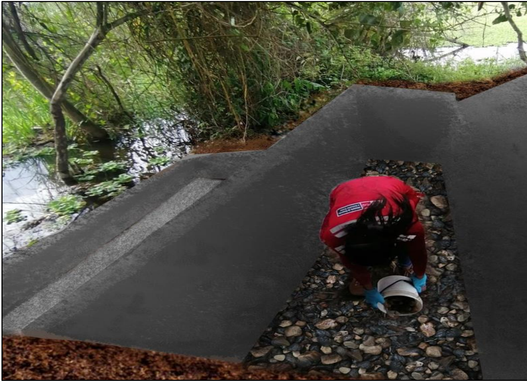
Agregado de piedra en la cámara descendente. Fuente: Elaboración propia, 2021.
