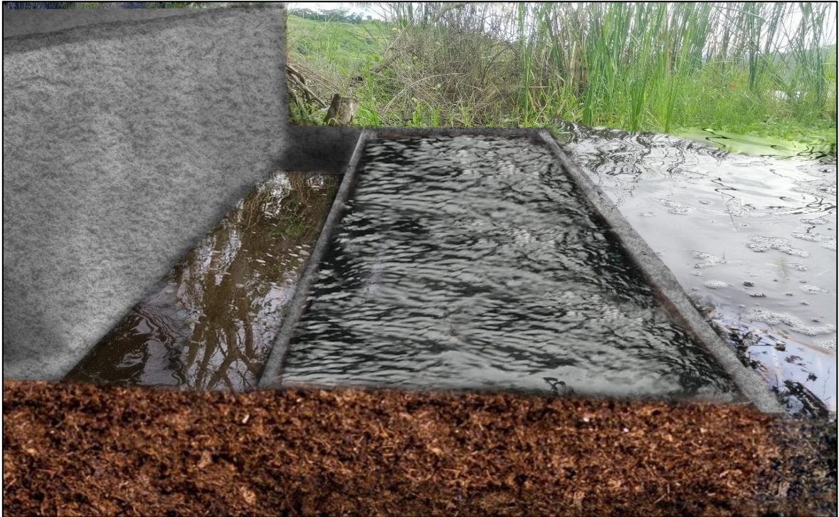
Cámara húmeda y cámara ascendente en funcionamiento.
