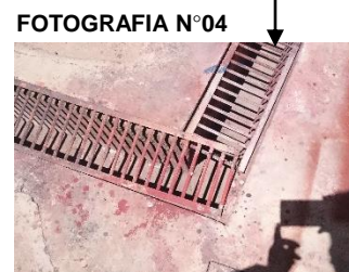
FUENTE: ELABORACION PROPIA. - Rejillas de drenaje los cuales impiden el libre transito de personas con silla de ruedas.
