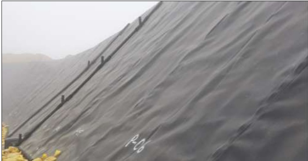
Figura 60: Quenas con tubería HDPE (sistema de drenaje de aguas) Fuente: Elaboración propia
