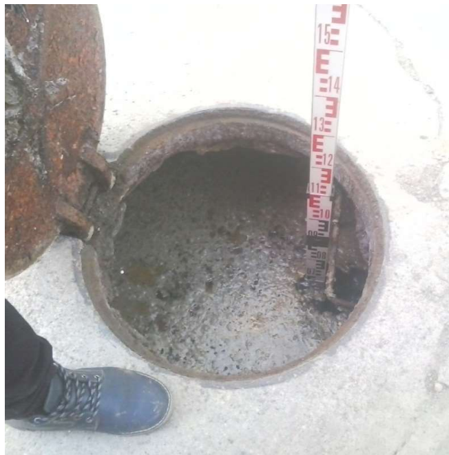
Figura 16. Buzón existente N°60 colmatado de aguas servidas
