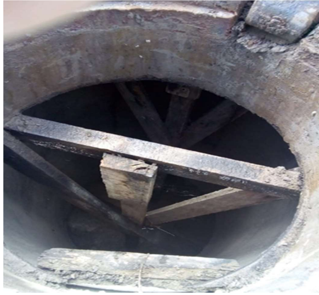
Figura 13. Buzón con presencia de encofrado rezagado.
