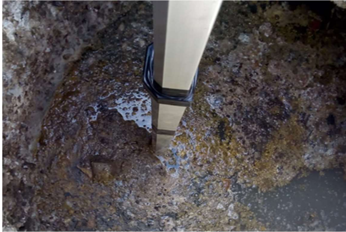
Figura 11. Presencia de sólidos en cámara de inspección
