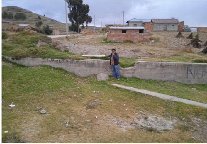
Figura 10. Situación de la tubería que cruza por el canal
