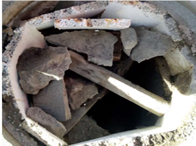
Figura 12. Presencia de hormigón, arena y basura
