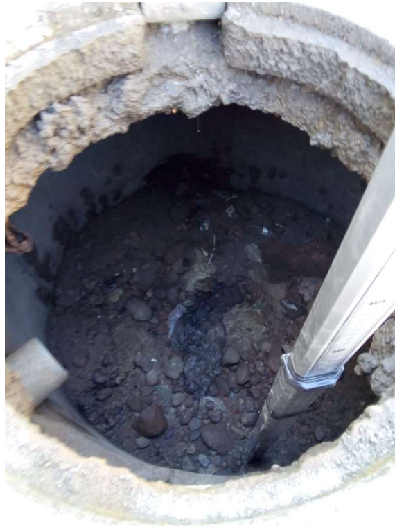
Figura 17. Buzón N°48 con presencia de sedimentos
