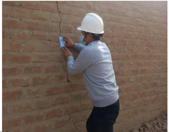
En la imagen se observa Grietas de 0.5cm de ancho y 1.80 de largo.
