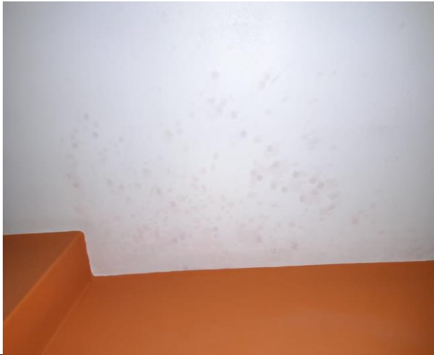
En la imagen se observa manchas de Humedad en la losa aligerada.
