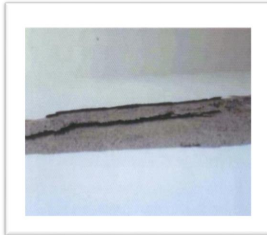
Figura N° 04. Fisura en el suelo
