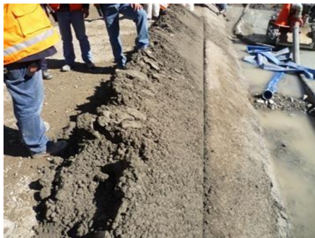
Figura 2 Concreto curb - desempeño inadecuado
