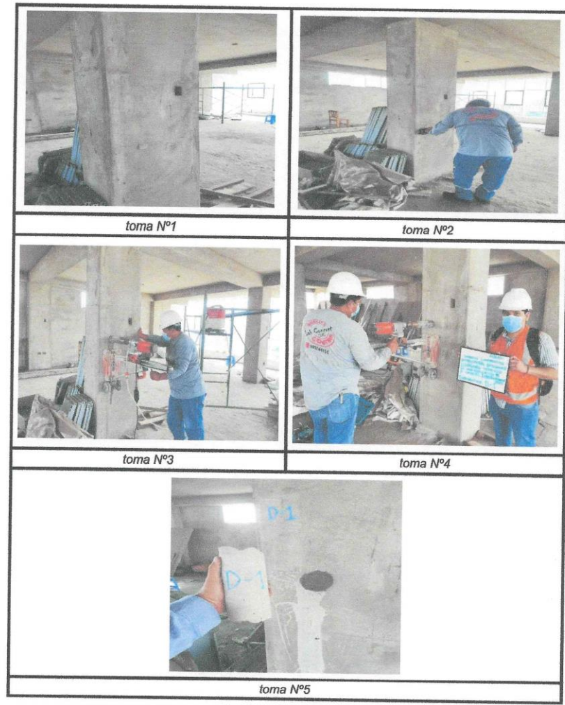
Figura N° 13: Área de la zona de trabajo e instalación de equipos de trabajo. Elaboración: Fuente Propia
