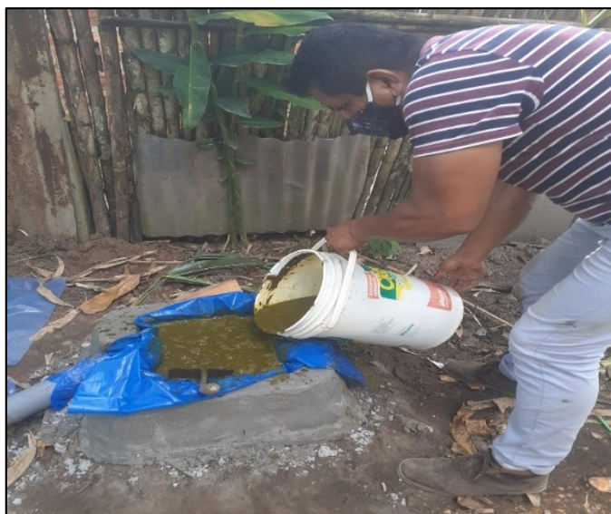
Figura N° 14: Carga del biodigestor con la mezcla.
