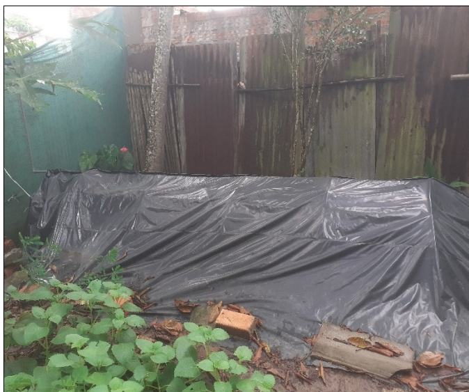
Figura N° 16: Biodigestor Tubular parte externa.
