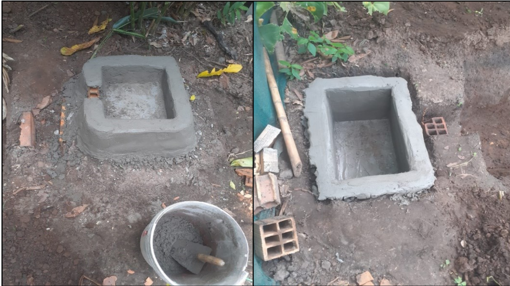
Figuras N° 08: Construcción de cajas de entrada de mezcla y salida de biol.
