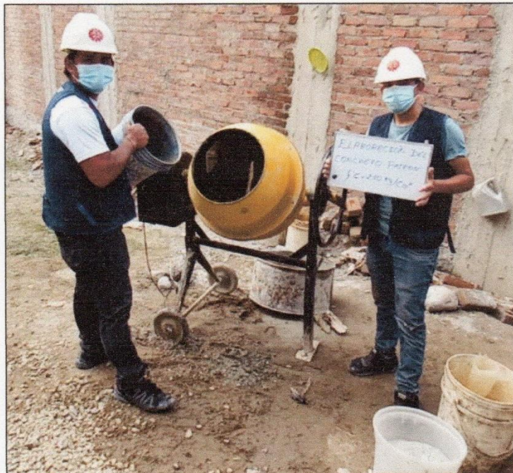
FOTOGRAFÍA 02: Adición de los agregados fino y grueso, agua y cemento a la mezcladora de concreto.
