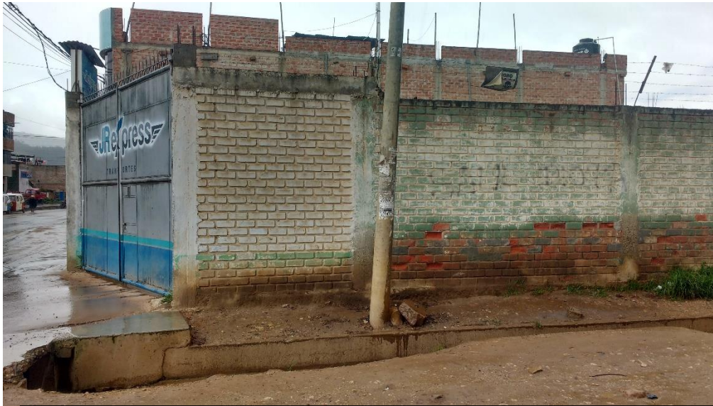
Figura 23. Cercos perimétricos afectados por la humedad. Fuente: elaboración propia
