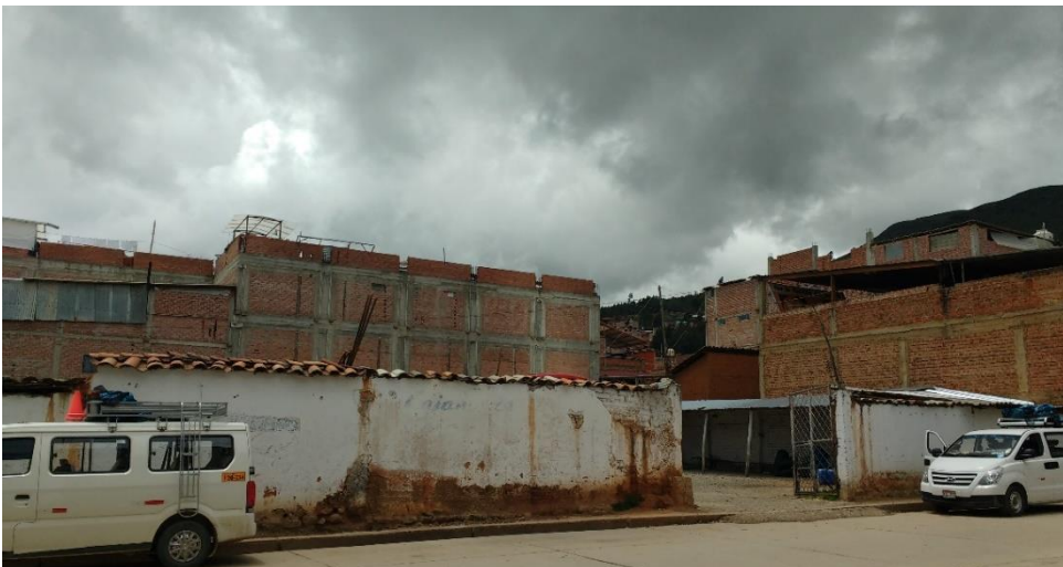
Figura 21. Cercos perimétricos de adobe en malas condiciones. Fuente: elaboración propia
