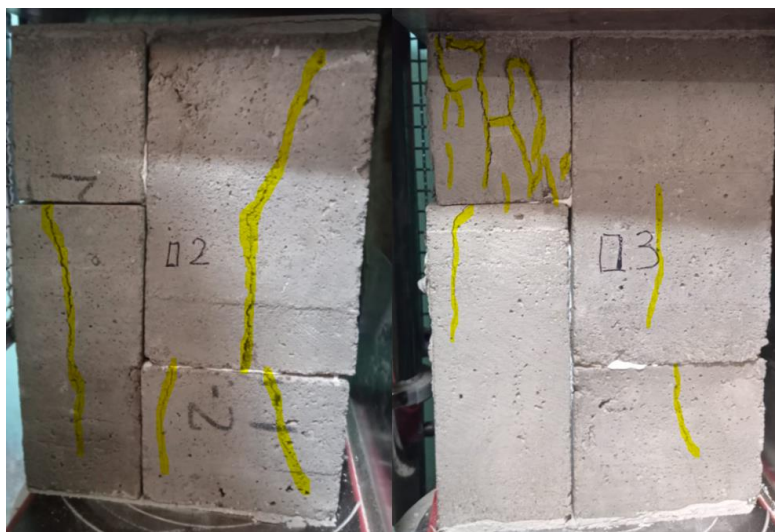
Figura 75. Tipo de fallas en pilas confeccionadas con bloques tipo II.
