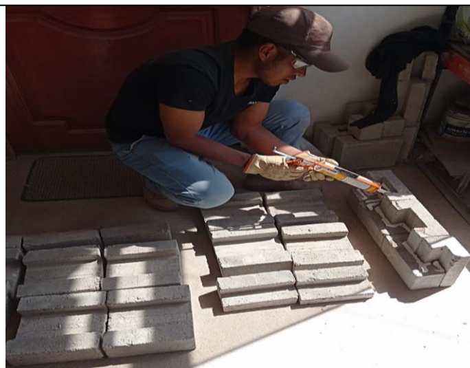
Proceso de armado de murete con bloque tipo I y pegado con Sikaflex-118
