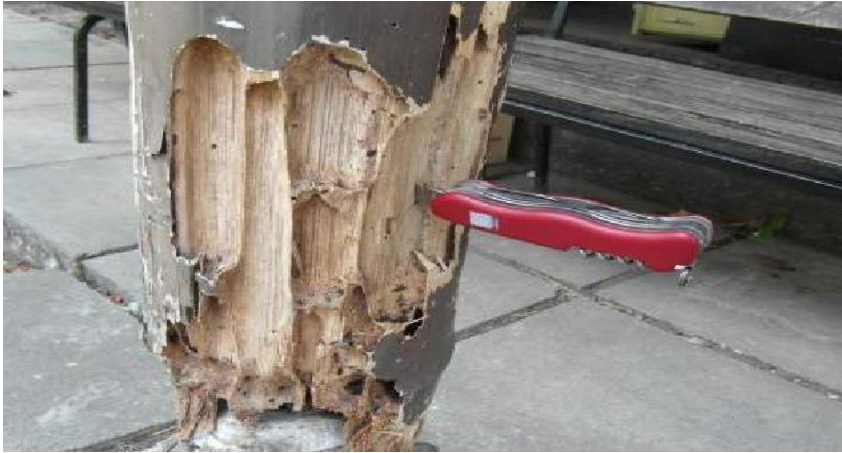
Imagen 4: Daños severos en la pieza del bambú causado por termitas
