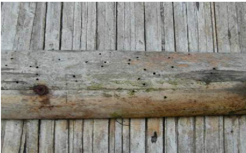
Imagen 5: Daño fúngico, blanqueo y partición del bambú
