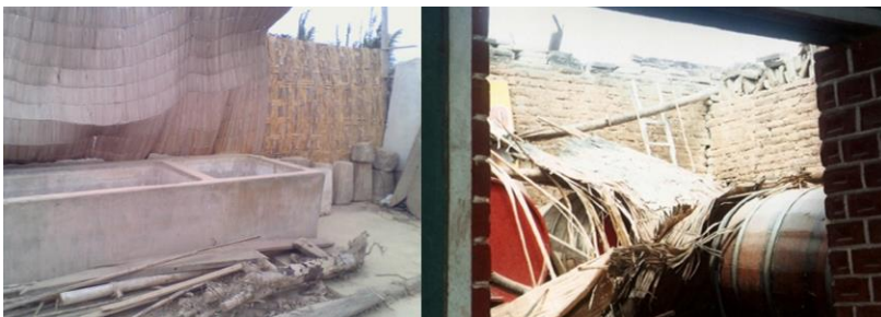
Figura N°6. Vista problemática en la infraestructura en el área de proceso
