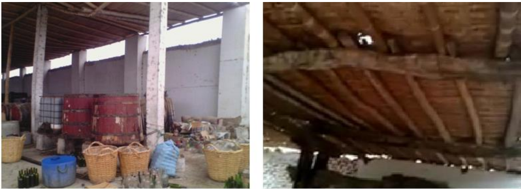
Figura N°1. Vista de las inadecuadas condiciones físicas del área de producción.
