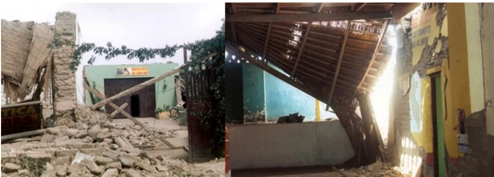
Figura N°8. Vista problemática en la infraestructura en el área de envasado y embotellado
