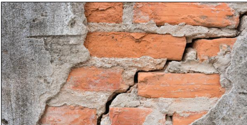
Figura 10. Deterioro de pared debido a factores externos. Recuperado de: https://rpp.pe/campanas/contenido-patrocinado/que-tipo-de-ladrillo-usar-para-evitar-riesgos-en-tu-vivienda-noticia-1121269
