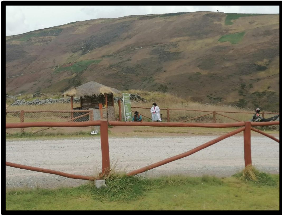
Imagen 3: Boletería y guardia en precario estado.
