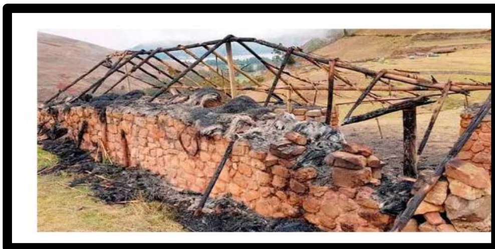
Imagen 5. Daños en el recurso por falta de guardianía.
