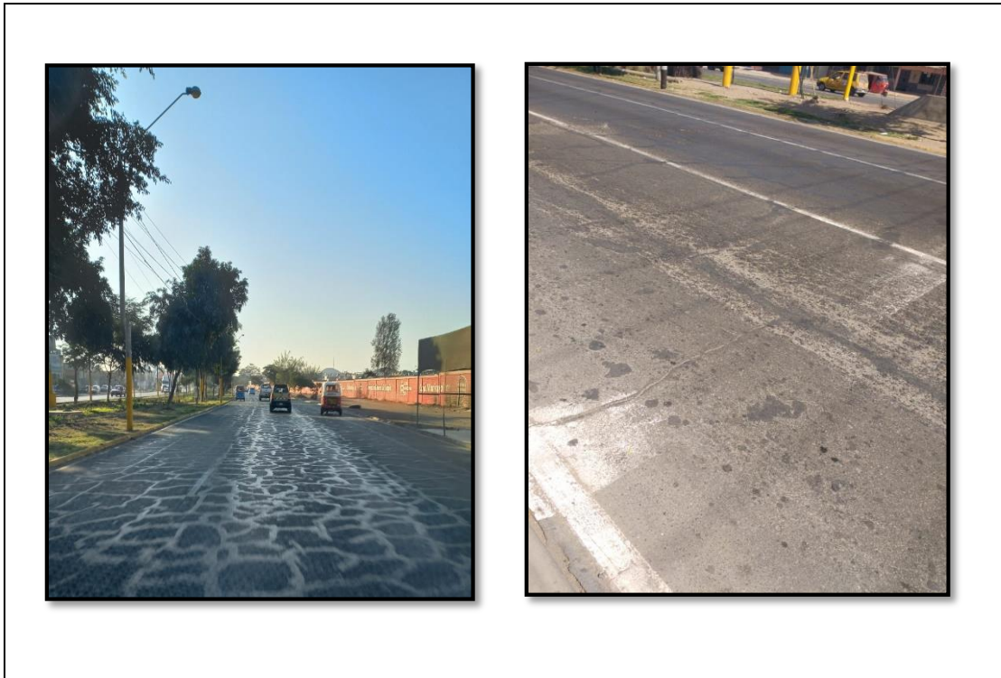
Figura 2. Parches y desgaste de la carpeta alfáltica - Panamericana Sur, Ica.
