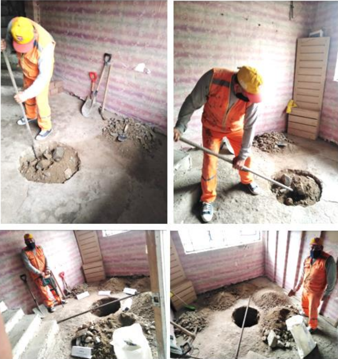
Figura. Se realizó la excavación de la primera muestra de la calicata C-1, con las siguientes indicaciones al señor Felipe Lévano Arias, que separe cada la muestra según la excavación 10cm, 20cm, 30cm, 50cm, 70cm, 1m, hasta que llego al suelo gravoso al 1.2m. El objetivo era observar las características de cada uno de las muestras según la descripción. Se concluye que se llegó a 1.20m por estar la vivienda ubicada cerca al cerro haciendo de ello un suelo granular de gravas.
