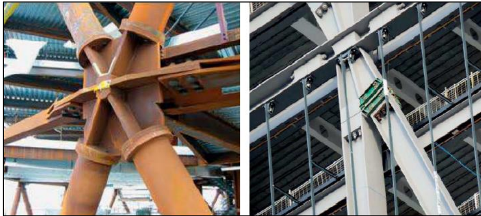
Figura 3. Nudos (nodos) de acero en el sistema Diagrid Fuente: Terri Meyer Boake, 2014
