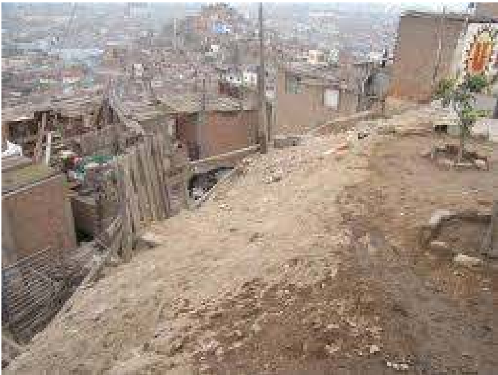
Figura 4. Falta de accesos de evacuación siendo un problema para las personas mayores, niños, mujeres embarazadas.
